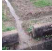
落水口と排水溝の連結
